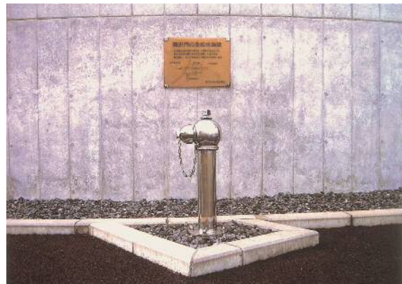
災害用応急給水栓
