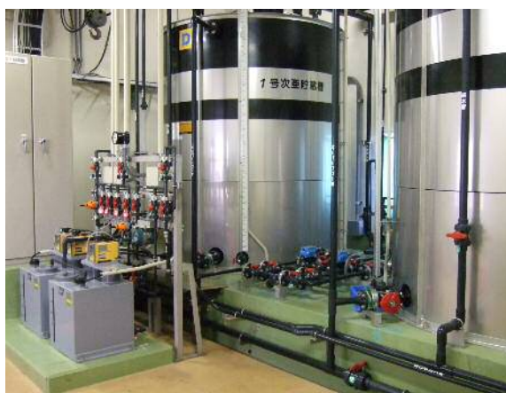
次亜塩素注入設備
