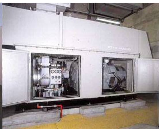
自家発電設備
