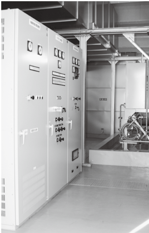
▲非常用自家発電機計装盤
